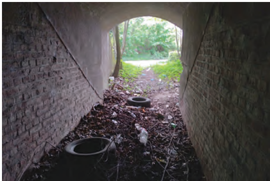
Niestety wewnątrz tunelu wymaga niewielkiego oczyszczenia
